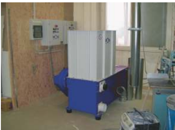
GAZ 62 Installation an eine Absaugung
